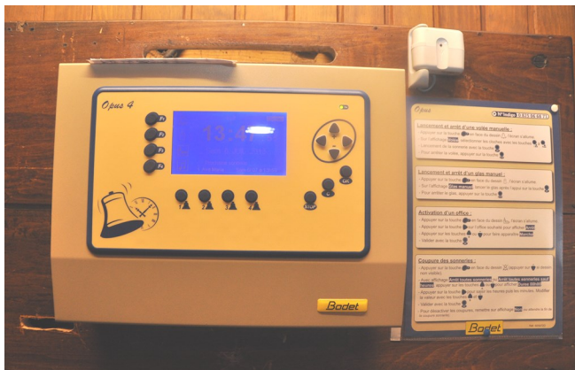
Le nouveau système de commande de sonnerie des cloches
